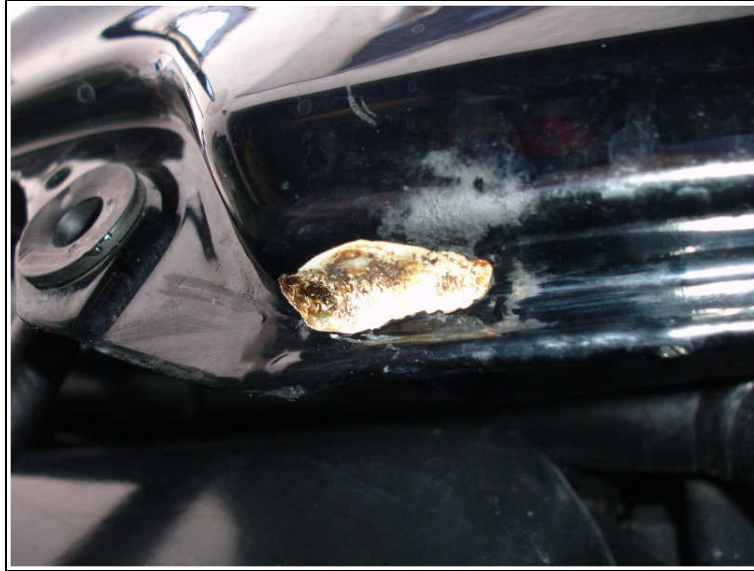
Abb.: 6-1 – Ursprüngliche Schadstelle
